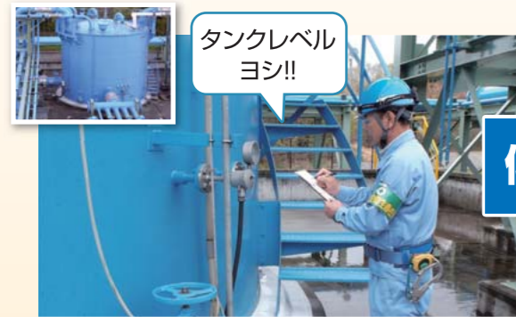
作動油を貯蔵しています。主油タンクの作動油をオフラインにて、フィルタリング(ゴミを取り除く)と冷却をするための循環ラインも設置されています。
