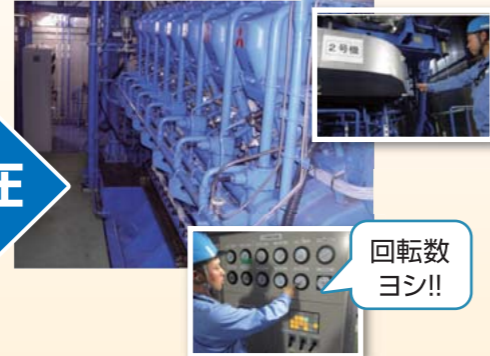
ガスエンジンを動力源として、作動油の圧力を上げて、加振機へ送ります。
