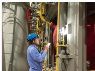
(高圧ガス製造設備)
