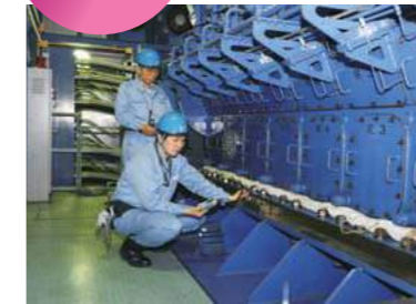
■ガスエンジンの振動測定
